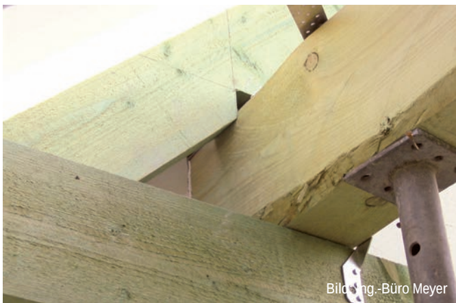
Abb. D3.1 Risse in Bekleidungen vom Dachgeschoss haben ihre Ursache oft im Schwund der Mittelpfette. Diese im nassen Zustand eingebaute Pfette wird im Laufe der folgenden Monate um ca. 15 mm schwinden. Selbst ein einstiellig geschnittenes KVH wird um ca. 10 mm schwinden. Das Problem ist, dass sich die Schwindverformung nach dem Ausbau des Daches einstellt. Die Folge sind Risse in den Bekleidungen.
