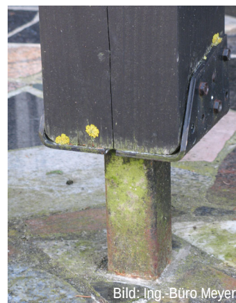
Abb. F3.4 Dieser U-Pfostenträger ragt über die Kante der Holzstütze hinaus. Niederschlagswasser kann so in großer Menge in die Hirnholzfläche eindringen.
