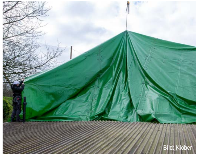
Abb. E1.17 Auch das ist eine Möglichkeit einer Behelfsdeckung. Auf der Baustelle wird eine großformatige Abdeckplane vorgehalten.
