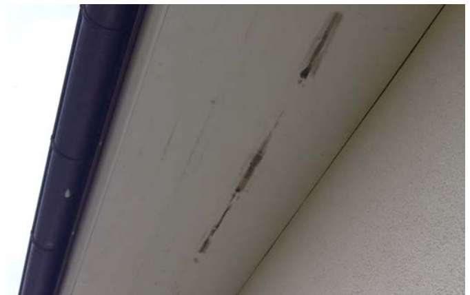
Abb. F2.3 Verschiedene Ursachen können zu einer Schimmelbildung im Bereich von Dachüberständen führen.
