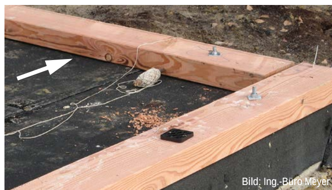
Abb. G1.12 Fugen im Bereich 5-10 mm sind ungünstig. Es ist nicht möglich diese mit Mörtel nachträglich auf ganzer Breite zu unterfüttern. Fehlt die vollflächige Auflage, ergeben sich Setzungen des Gebäudes.
