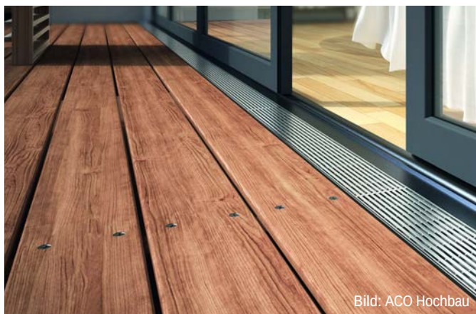
Abb. F4.10 Holzdielen mit Fugen sind als Belag zu sehen, von dessen Oberkante die Abdichtungshöhe zu bemessen ist. Ein barrierefreier Zugang, wie im Bild zu sehen, stellt immer eine Sonderlösung dar.
