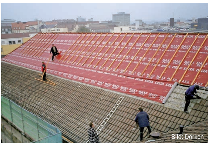
Abb. E1.16 Diese Unterdeckung muss als Behelfsdeckung ausgebildet werden. Die unterhalb liegenden Wohnungen müssen bis zur Fertigstellung der Dachdeckung zuverlässig vor Niederschlag geschützt werden.
