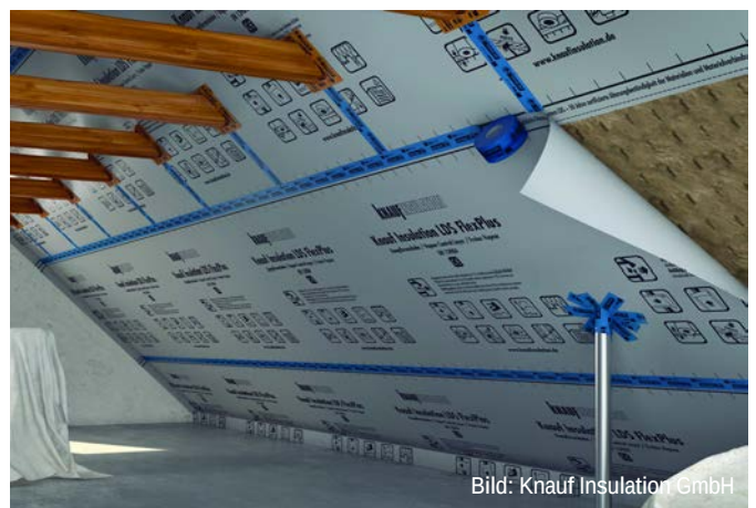
Abb. C4.24 Werden unbeheizte Nebenräume mit einer Dämmung und einer Dampfbremse versehen, ist das Phänomen der Kondensatbildung ausgestanden. Damit ergibt sich auch ohne Beheizung ein gemäßigtes Raumklima. Wertvoller Hausrat ist vor Feuchte geschützt.
