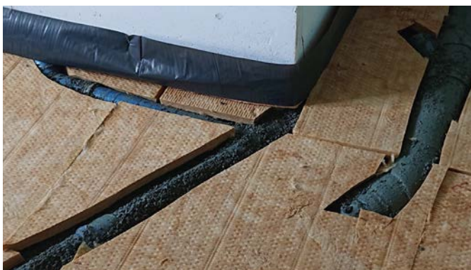
Abb. C7.25 Mangelhafte Ausführung: Schallbrücken durch Ausparung der Trittschalldämmplatten im Bereich der Rohrleitungen.
