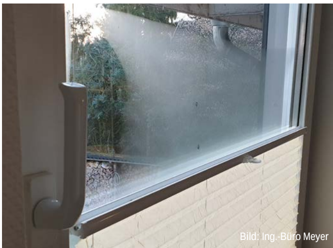
Abb. C1.26 Kondensatbildung an einem Fenster.
