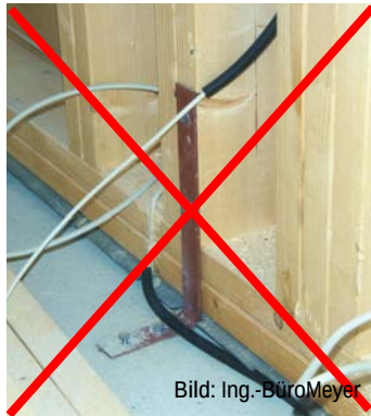
Abb. G2.32 Installationen in der Hauptdämmebene sind zwar möglich, jedoch nicht in dieser Ausführung. Es ist quasi unmöglich eine hochwertige Luftdichtung in dieser Art auszuführen.
