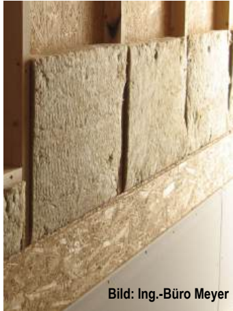
Abb. E7.4 Zweilagige Beplankung der Installationsebene mit OSB-Vollschalung und Gipsplatten. Bild: Ing.-Büro Meyer
