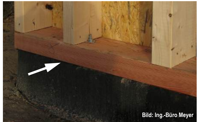
Abb. G2.17 Hier liegt die Schwelle vollflächig auf, der Kraftschluss ist gewährleistet. Dies setzt eine Betonplatte mit einer Höhentoleranz von \pm 5 mm voraus.
