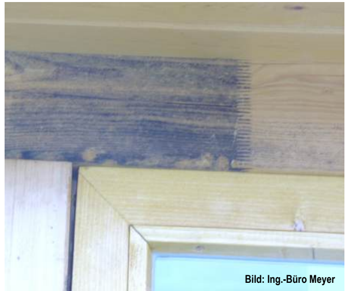
Abb. C4.29 Es gehört zu den besonderen Phänomenen, dass Holz unterschiedlich befallen sein kann. Das linke Holz neben der Keilzinkung ist unsauber gehobelt. Entsprechend größere Mengen Glukose sind auf der Oberfläche verblieben. Das Schimmelwachstum wird begünstigt.
