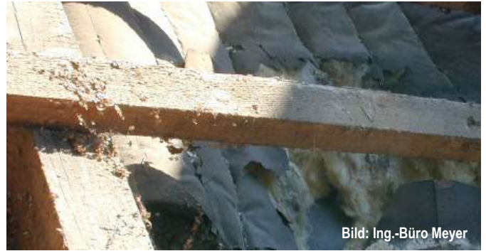
Abb. B1.9 Bei der Öffnung eines Daches wird der Dämmstoff aus vergangenen Zeiten sichtbar. Es wird dabei die Frage erörtert, ob der Verbleib des Dämmstoffs einen Nutzen haben könnte oder eher schadet.
