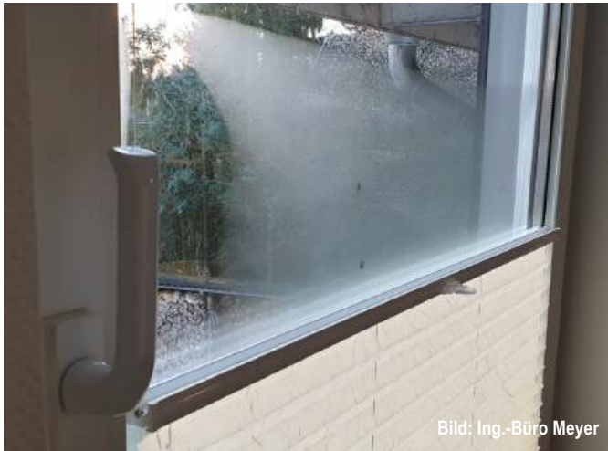
Abb. C1.36 Kondensatbildung an einem Fenster
