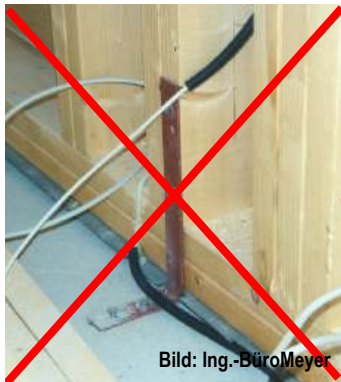
Abb. E7.5 Installationen in der Hauptdämmebene sind zwar möglich, jedoch nicht in dieser Ausführung. Es ist quasi unmöglich eine hochwertige Luftdichtung in dieser Art auszuführen. Bild: Ing.-Büro Meyer
