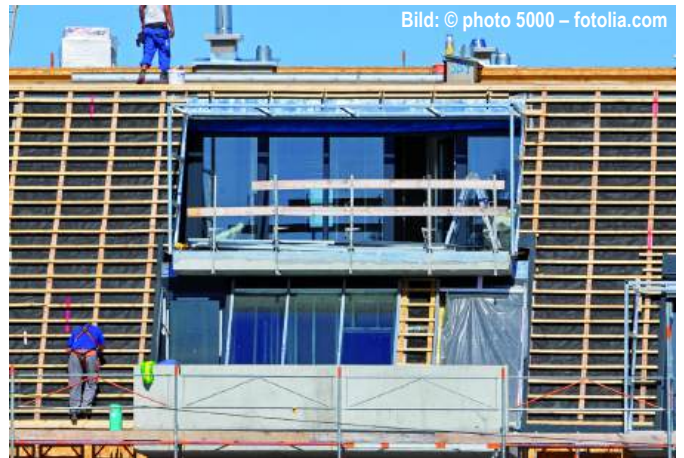
Abb. C5.18 Die Ausführung einer Traglattung unter Dachdeckungen und geschlossenen Fassaden ohne chemische Holzschutzmaßnahme ist gemäß DIN 68800 anerkannte Regel der Technik. Das Trocknen der Latten ist schon deshalb erforderlich, um einen Schimmelbefall während der Lagerung zu vermeiden.
