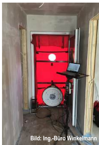
Abb. C2.13 Die Differenzdruckmessung wird gemäß Gebäudeenergiegesetz (GEG) nach DIN EN ISO 9972 durchgeführt. Weitere Hinweise enthält DIN 4108 Teil 7.
