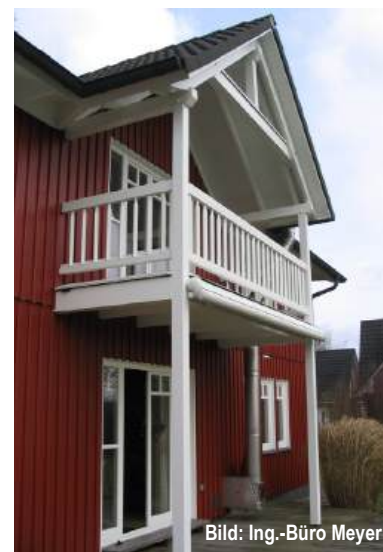
Abb. C5.12 Balkone sind typische Beispiele für bewitterte Konstruktionen. Hier kommt es sehr auf die Detailausbildung an. Ziel ist es, Stauwasser in der Holzkonstruktion zu vermeiden.
