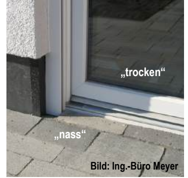
Abb. E1.6 Bei diesem Wohnhaus wollte die Baufamilie das Gelände niveaugleich zum Innenraum. Dies sollte nur dann umgesetzt werden, wenn keine Gefährdung durch Oberflächenwasser aus Starkregen besteht. In diesem Beispiel fehlt eine Entwässerungsrinne vor dem Ausgang. Bei Windeinwirkung könnte Wasser eintreiben.
