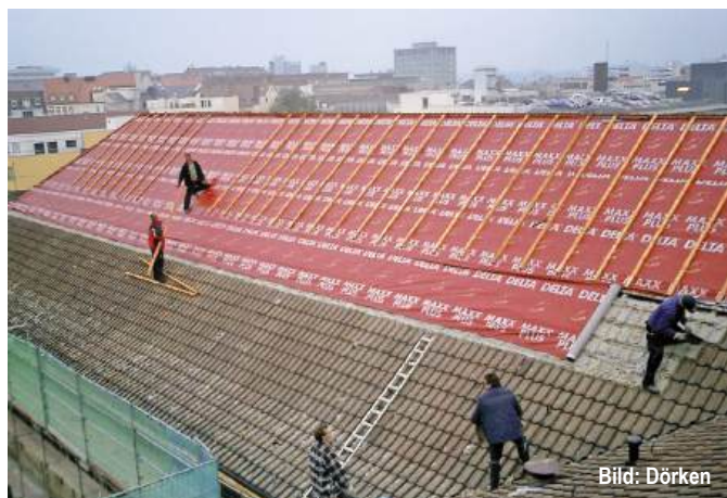
Abb. E3.19 Diese Unterdeckung ↑ muss als Behelfsdeckung ausgebildet werden. Die unterhalb liegenden Wohnungen müssen bis zur Fertigstellung der Dachdeckung zuverlässig vor Niederschlag geschützt werden.
