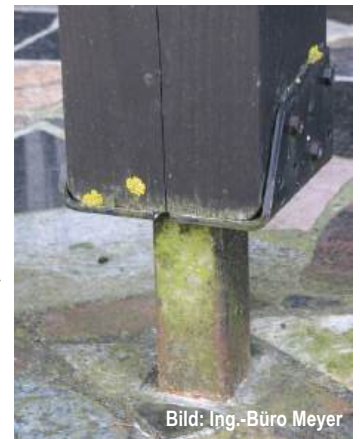
Abb. F5.4 Dieser U-Pfostenträger ragt über die Kante der Holzstütze hinaus. Niederschlagswasser kann so in großer Menge in die Hirnholzfläche eindringen.
