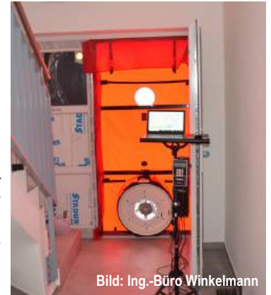
Abb. B1.3 Bei der „Blower-Door-Messung“ wird ein Luftdruck der Windstärke 5 simuliert. Ursachen für Zugluft im Raum (Leckagen) werden dann erkennbar.
