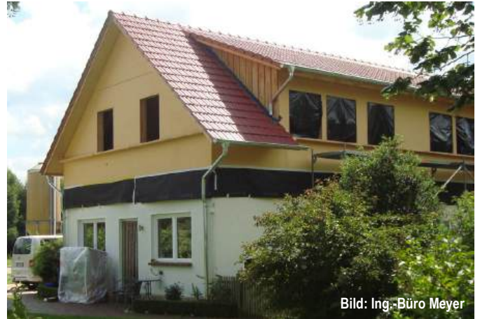
Abb. G5.1 Bei diesem Bestandsgebäude wurde das Dach abgetragen und um eine Aufstockung erweitert. Die Vorteile liegen in der nahezu uneingeschränkten geometrischen Form mit einer entsprechend verbesserten Wohnnutzung.
