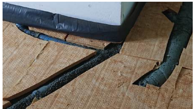
Abb. C7.31 Mangelhafte Ausführung: Schallbrücken durch Aussparung der Trittschalldämmplatten im Bereich der Rohrleitungen.
