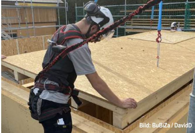
Abb. E2.8 Montage einer elementierten Deckenkonstruktion. Der Monteur ist unter den Aspekten der Arbeitssicherheit ausgerüstet.
