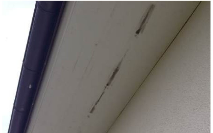
Abb. F4.3 Verschiedene Ursachen können zu einer Schimmelbildung im Bereich von Dachüberständen führen.
